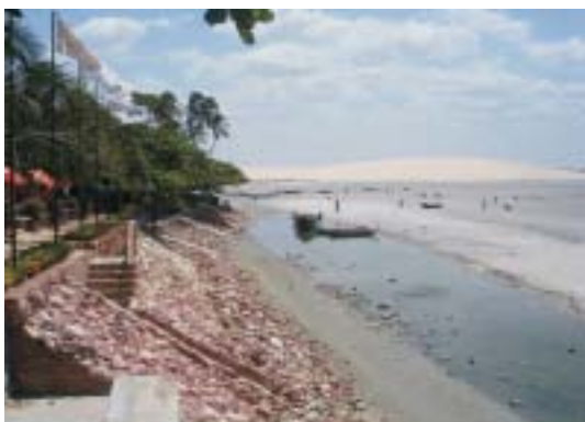
Fotografia 25 – Edificações sobre Setores de Domínio das Marés, Utilizando Muros de Contenção para Diminuir a Erosão (Ação Direta das Ondas) Durante a Maré Cheia
