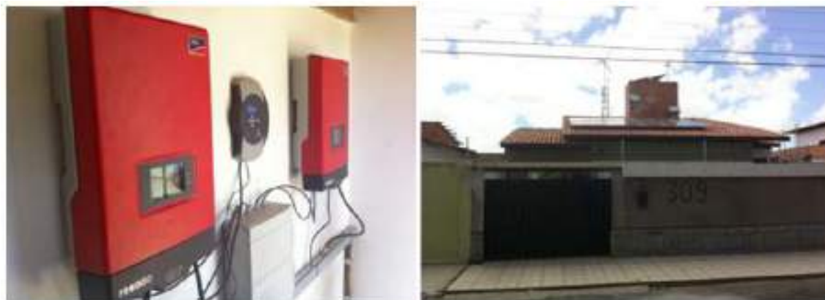
Figura 5 Instalação solar em residência (Fortaleza.)
