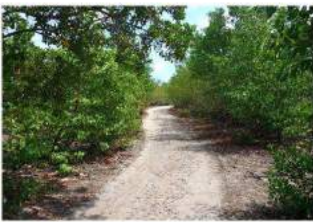
Figura 9 - Desmatamento do manguezal para construção de estrada.
