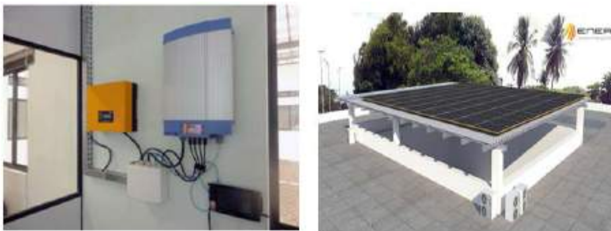
Figura 4 Instalação do Sistema Solar no CENEA. Fonte: ENER (2013).
