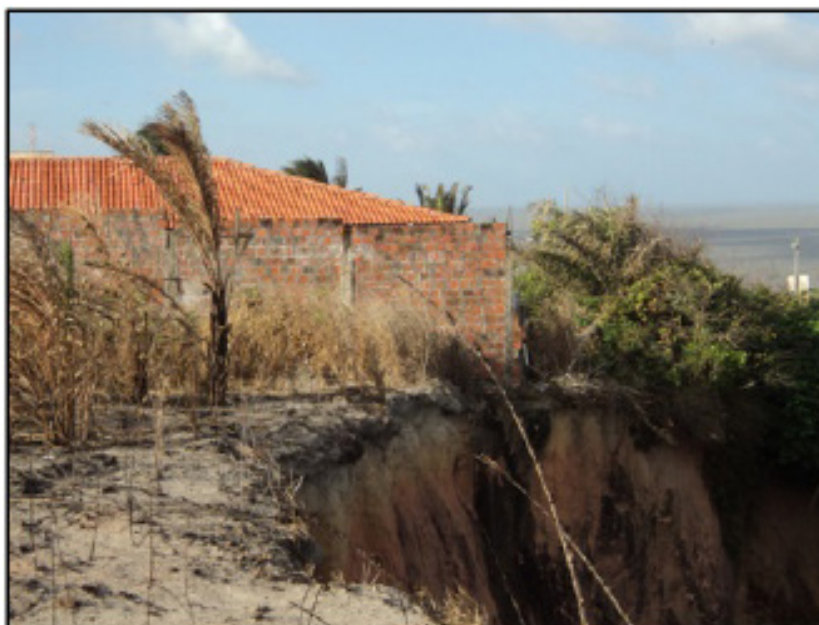
Figura 9: Residências próximas a voçoroca Araçagy II.
