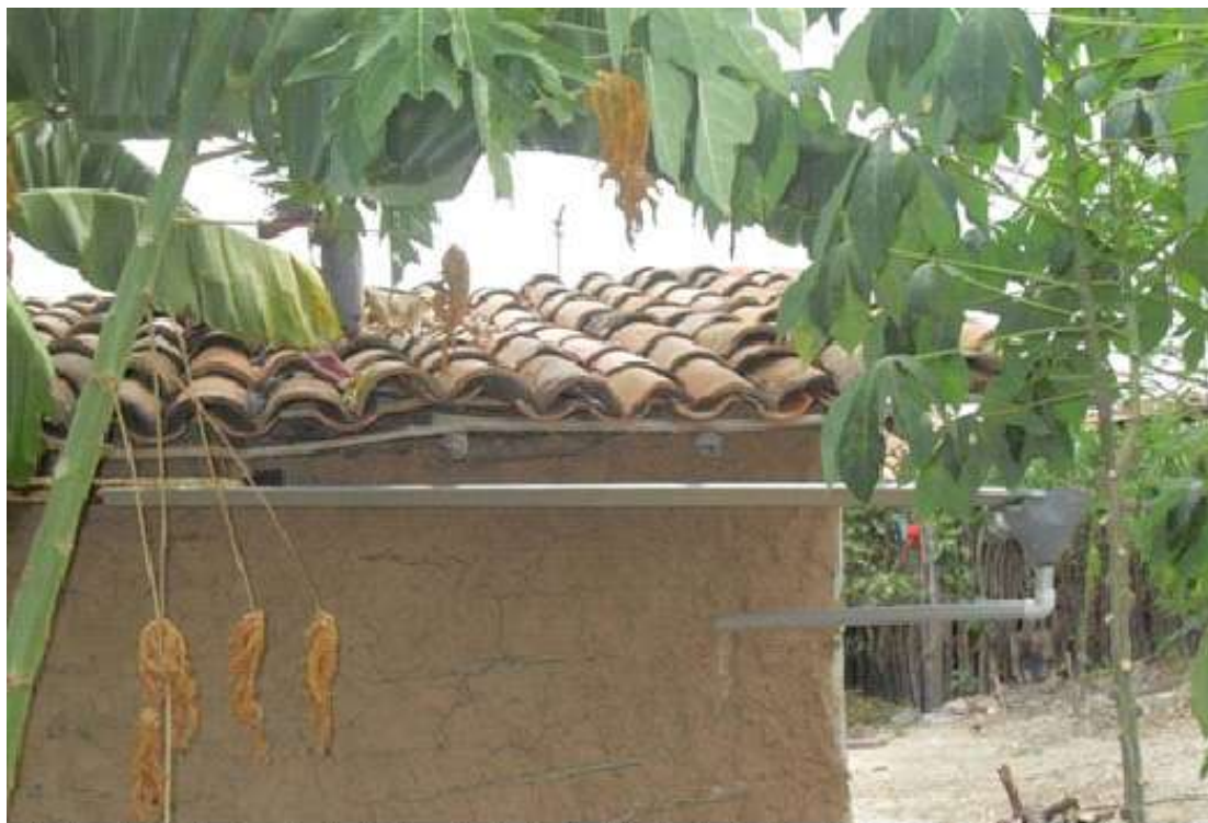
Figura 02: Sistema de captação das águas pluviais através de calhas.
