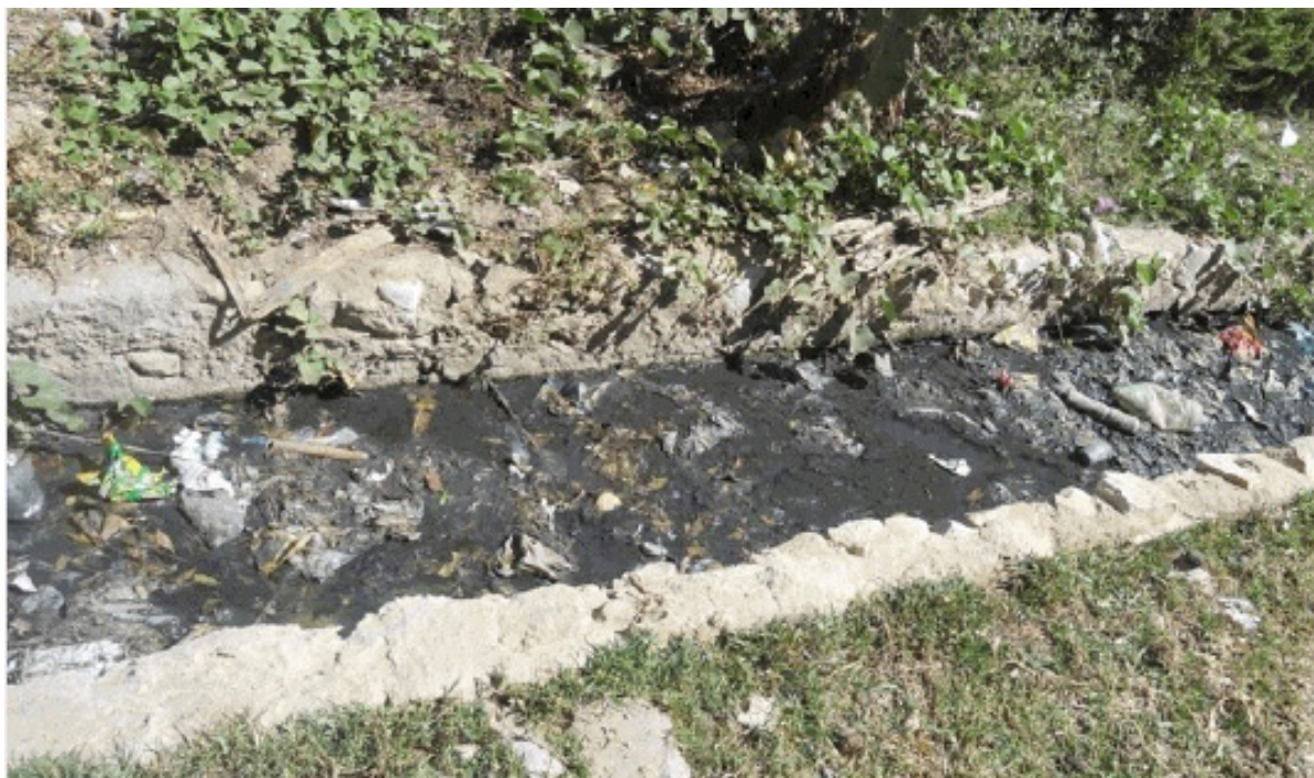
Figura 3: Esgoto a “céu aberto”, falta de saneamento bairro Pintos em Mossoró/RN
