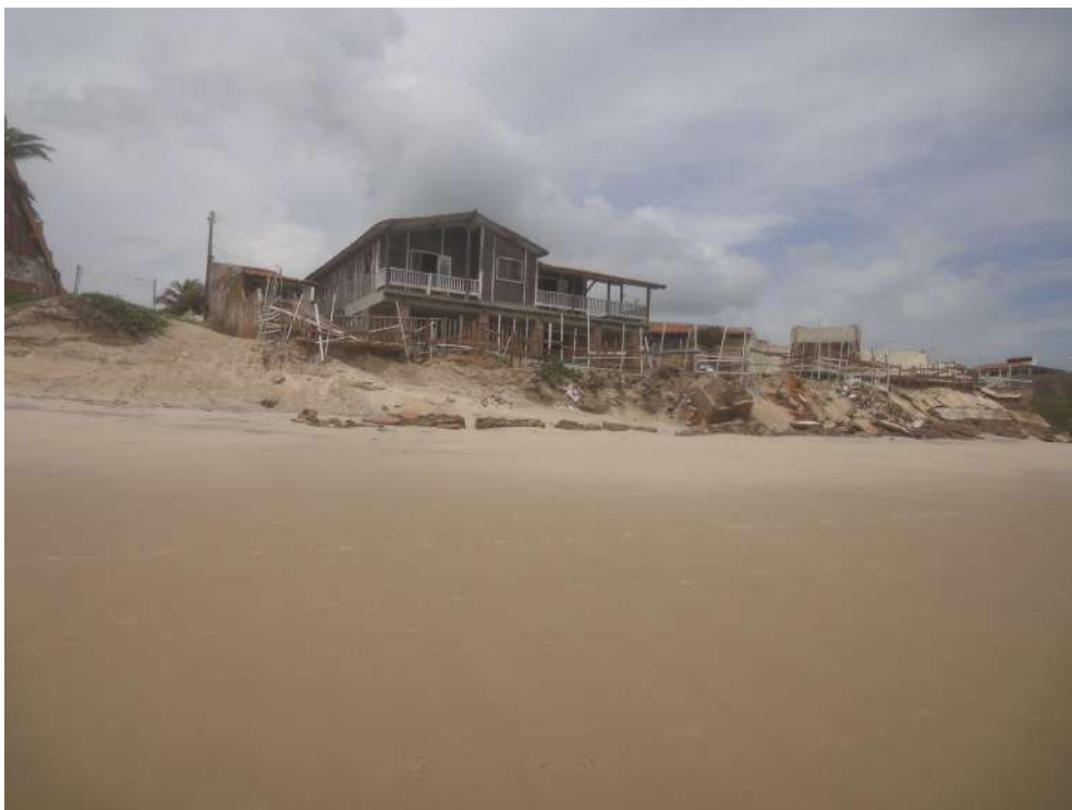
Figura 02 - Edificação atingida pela erosão costeira na Praia do Icarai.
