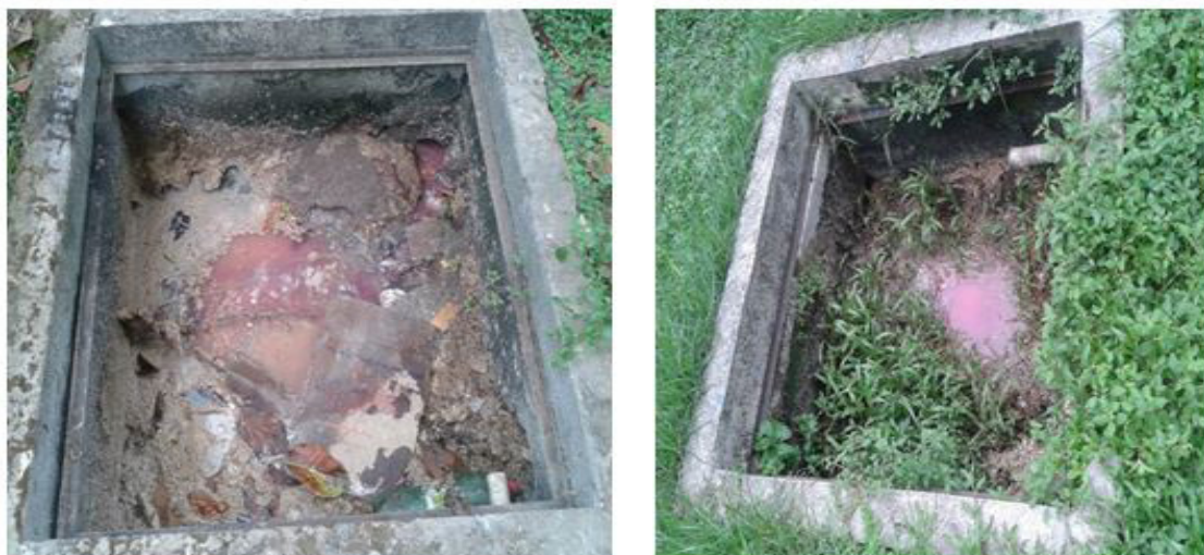
Figura 3 e 4 –Esgotos expostos localizados dentro do Campus CCSE-UEPA.
